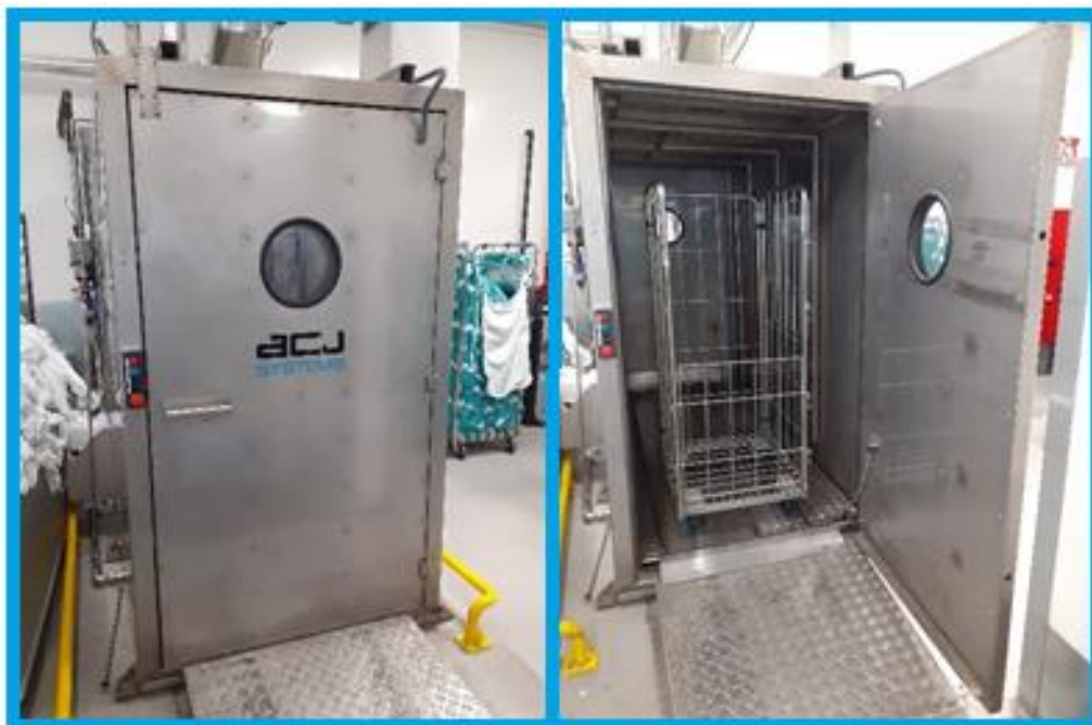
Imagen 7: Desinfección de carros: salida en la zona de limpio.
